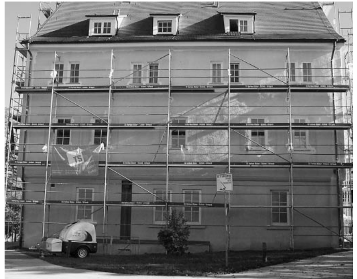
Nach gut 15 Jahren erfährt das Schloss Urbach mal wieder ein bisschen „Face-Lifting“. Dort, wo Putz und Farbe wieder anfangen zu bröckeln, sind die Malermeister zu Gange und lassen das altherwürdige Gemäuer wieder in frischer Farbe erstrahlen.
