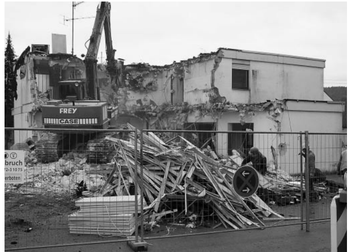
Das Postgebäude am Kreisverkehr Mitte wird abgebrochen. Es macht Platz für den Neubau von zwei Einkaufsmärkten und einem Ladenneubau in der neuen Urbacher Mitte. Baubeginn soll im Frühjahr nächsten Jahres sein.
