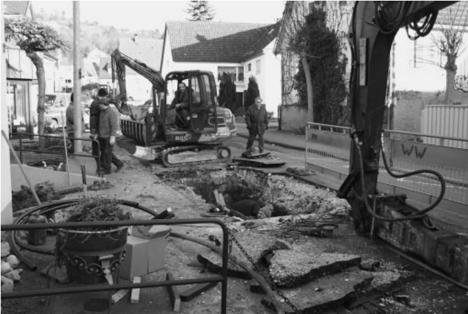
Die andauernde Kälte führt vermehrt zu Rohrbrüchen, wie hier in der Hohenackerstraße. Wassermeister Ernst Benzenhöfer und der Bauhof sind im Dauereinsatz, um die Wasserverluste nicht zu hoch werden zu lassen.
