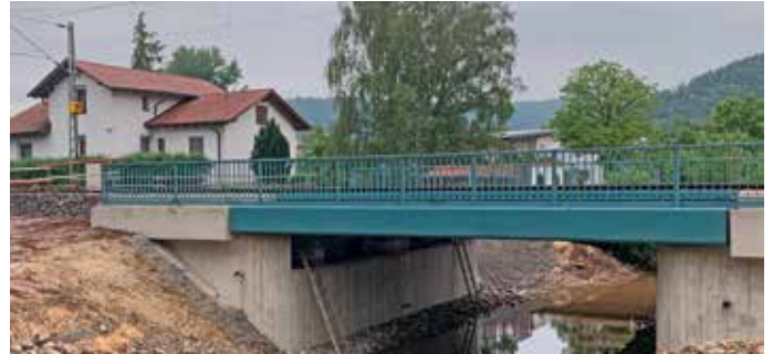
Die Eisenbahnbrücke über den Bärenbach zwischen Urbach und Plüderhausen wird nach rund 150 Jahren vollständig erneuert. Mit dem Einhub der Brücke im Ganzen ist der Zugverkehr auf der Remsbahn nur für rund eine Woche eingeschränkt.
