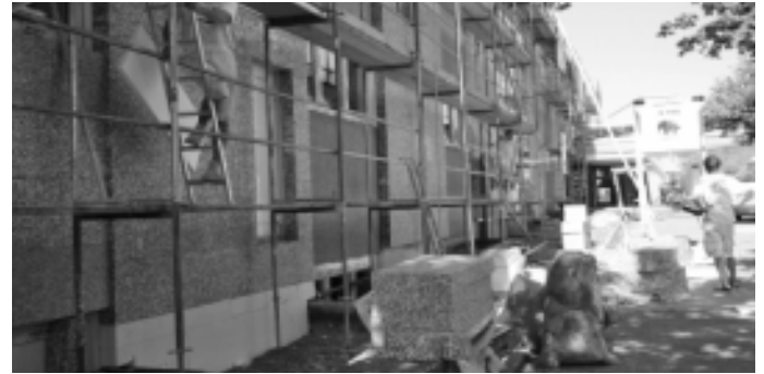
Die Wittumschule wird „eingepackt“. Im Rahmen des sogenannten Konjunkturpakets II erhält die Gemeinde vom Bund Zuschüsse für energetische Maßnahmen an öffentlichen Gebäuden. Mit einer effektiven Dämmung der Außenfassade an der Wittumschule können nicht nur die Energiekosten deutlich gesenkt werden, sondern die Gemeinde unternimmt auch etwas, um den CO 2 -Ausstoß zu reduzieren.
