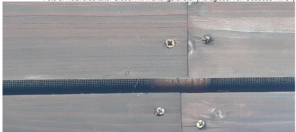
Foto 4: Holzverschalung mit feinmaschigem Drahtgewebe im Bereich der Dachtraufe
