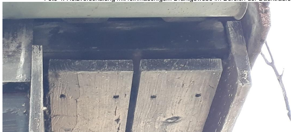
Foto 5: Holzverschalung mit Spalten im Bereich der Dachtraufe
